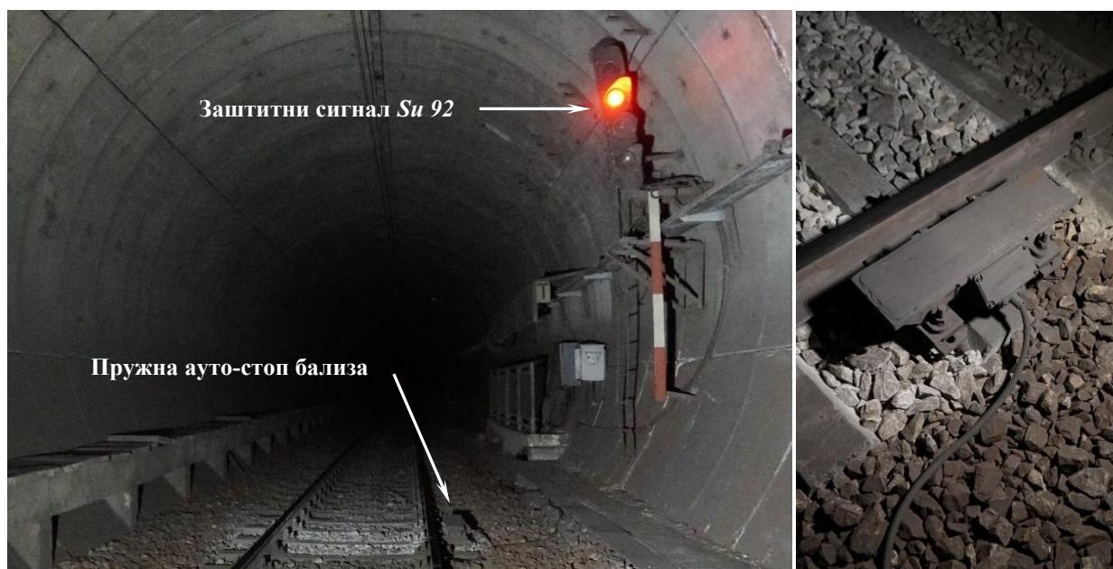
Слика 3.4.1.1: Изглед пружне ауто-стоп бализе уграђене код заштитног сигнала Su 92
