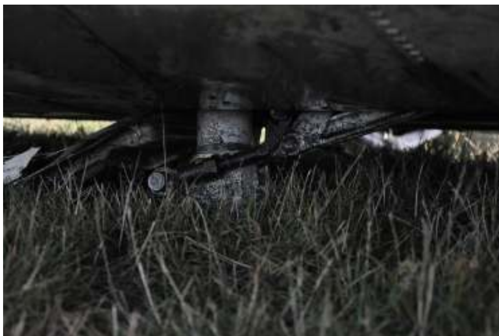
Слика 5. Затечено стање ноге стајног трапа
