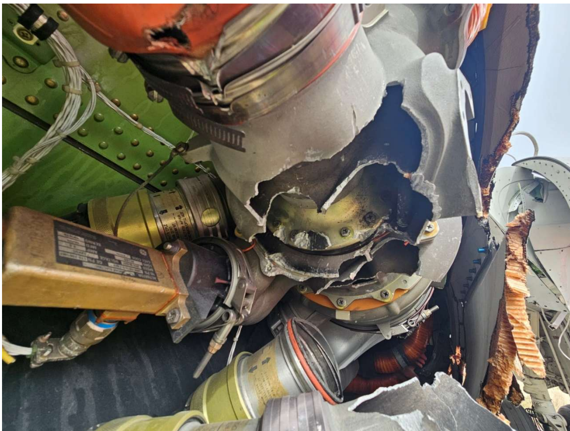
Слика 12. Оштећење левог система за климатизацију
