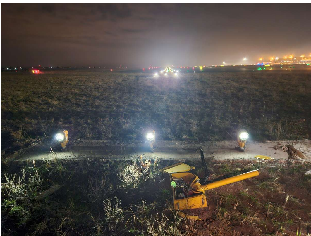
Слика 16. Оштећење система светлосног обележавања други ред светала од краја полетно слетне стазе
