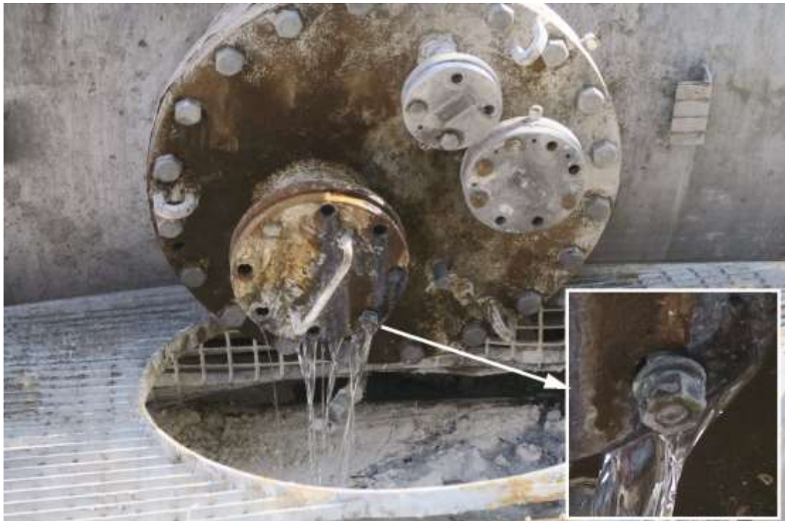
Слика 4.2.11.1: Цурење киселине на поклопцу отвора за пуњење
