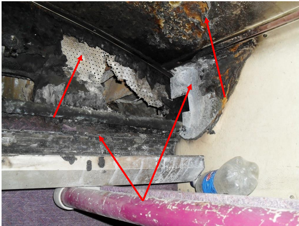
Слика 4.1.1.8: Изглед осталих металних делова захваћених пожаром
