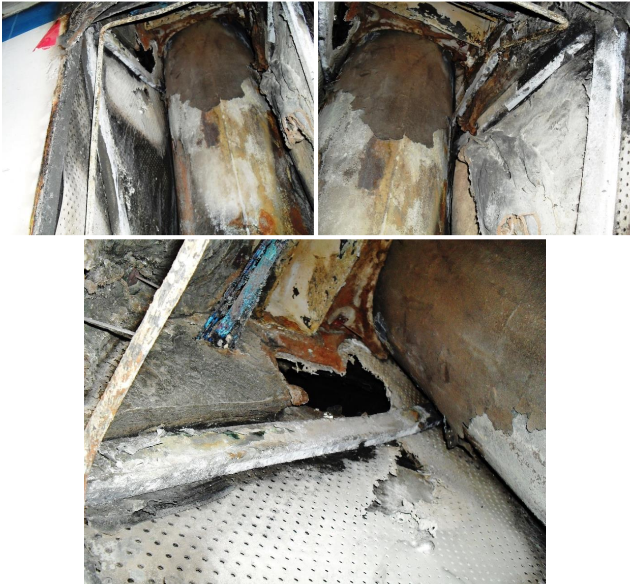
Слика 4.1.1.12: Делови изолације до металне заштитне цеви
