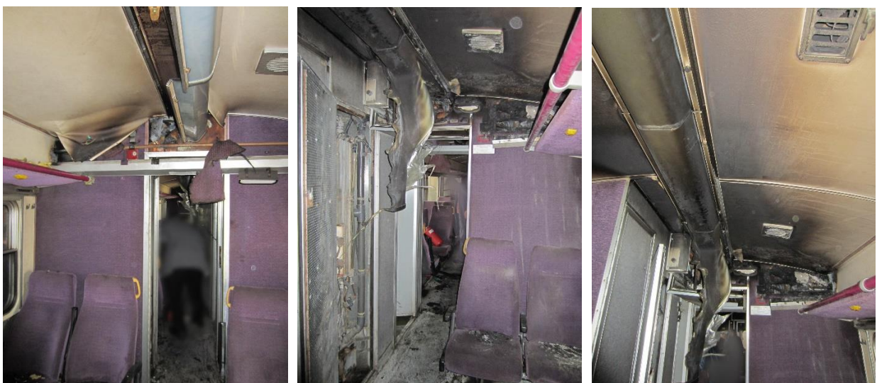
Слика 3.4.4.2: Изглед простора за путнике ДМК 710-004 захваћен пожаром
