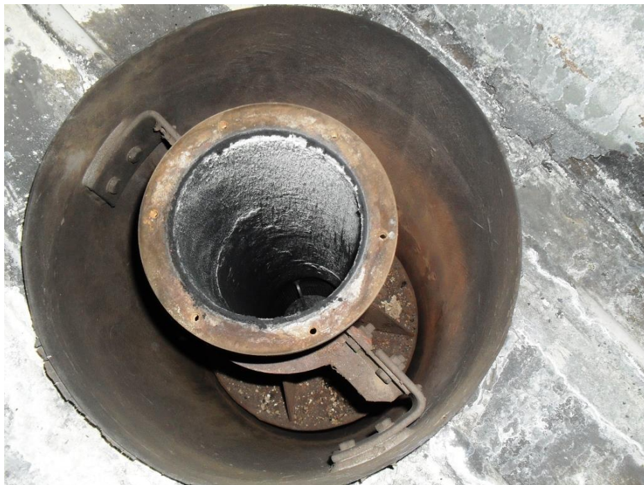
Слика 4.1.1.16: Изглед краја издувне цеви ДМ „А“
