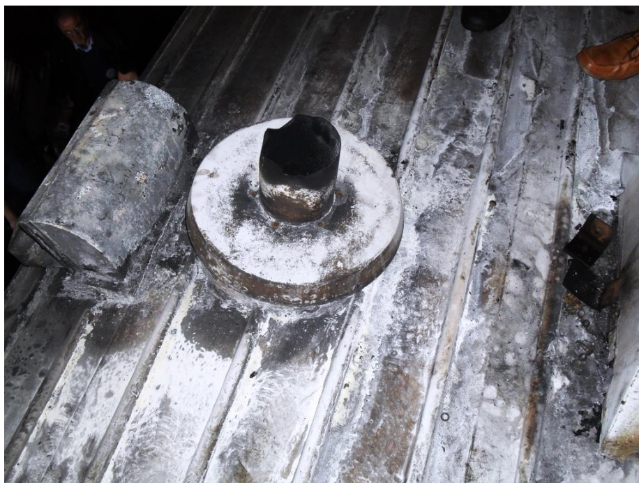
Слика 4.1.1.14: Изглед краја издувне цеви ДМ „А“
