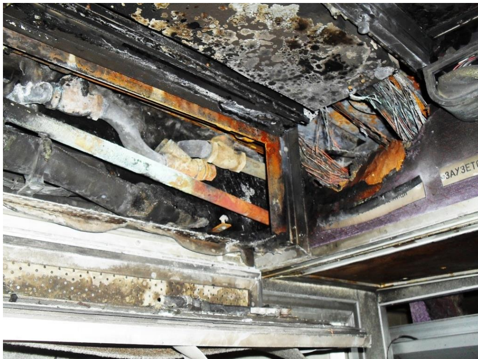
Слика 4.1.1.9: Изглед трагова горења на инсталацији у кровној конструкцији
