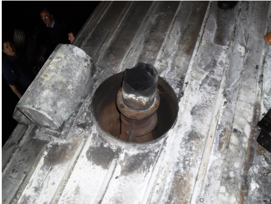
Слика 4.1.1.15: Изглед краја издувне цеви ДМ „А“
