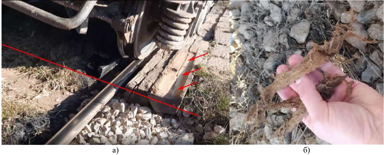
Слика 4.2.5.1.1: Издубљени део дрвене коловозне конструкције путног прелаза
