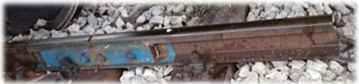
Слика 4.2.10.3: Изглед прснућа десне шине у смеру растуће стационаже левог колосека у km 123+660,20
