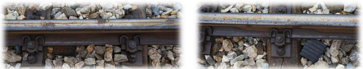
Слика 3.4.2.7: Изглед подужног померања шина
