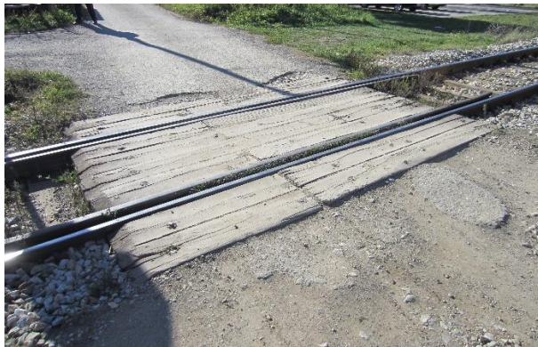
Слика 2.2.3.3: Изглед оштећења на коловозу пута
