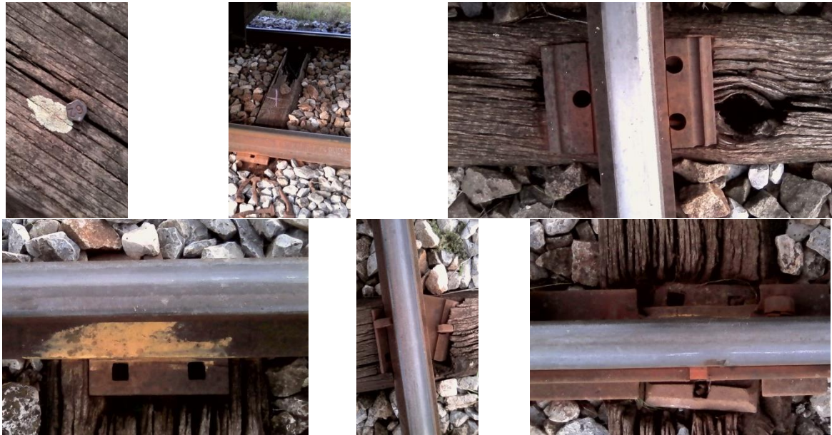
Слика 4.2.6.2: Локална трулеж испод ослонца шине и подужне пукотине прага
