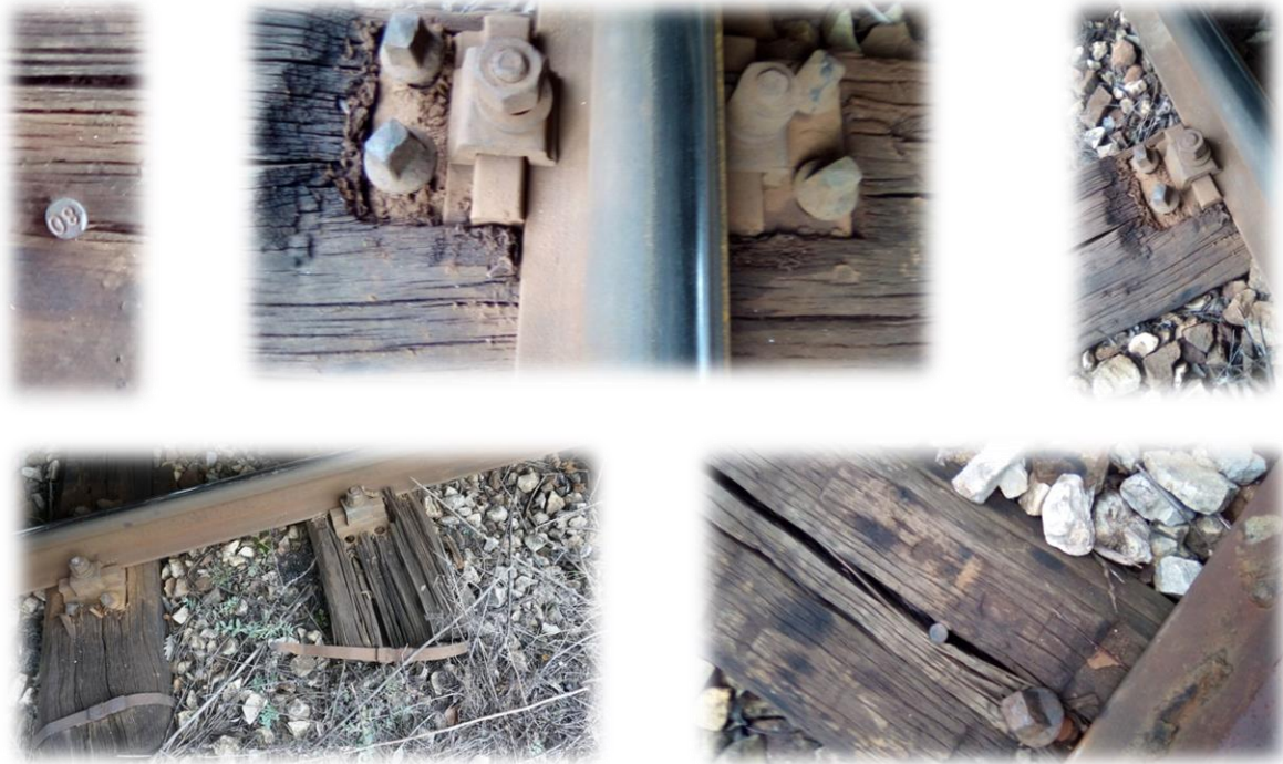
Слика 4.2.10.3: Локална трулеж испод ослонца шине и подужне пукотине прага
