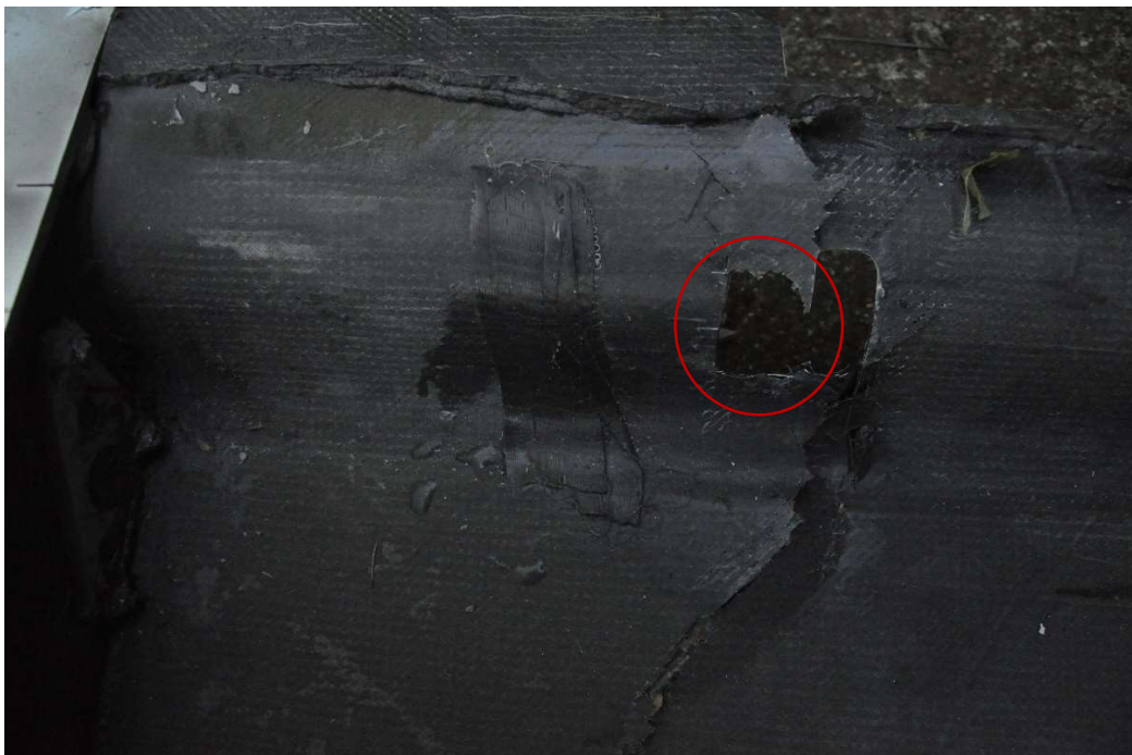
Слика 20. Зона унутрашњег качења крилца за крило и отвор који је настао услед чупања носача
