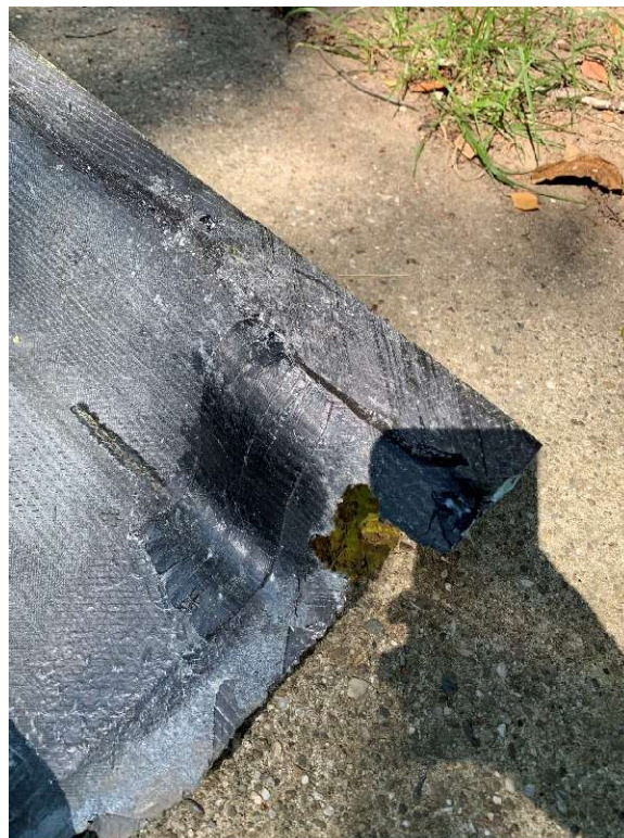
Слика 18. Поглед на оштећење у зони качења спољног носача крилца и поглед на ојачање
